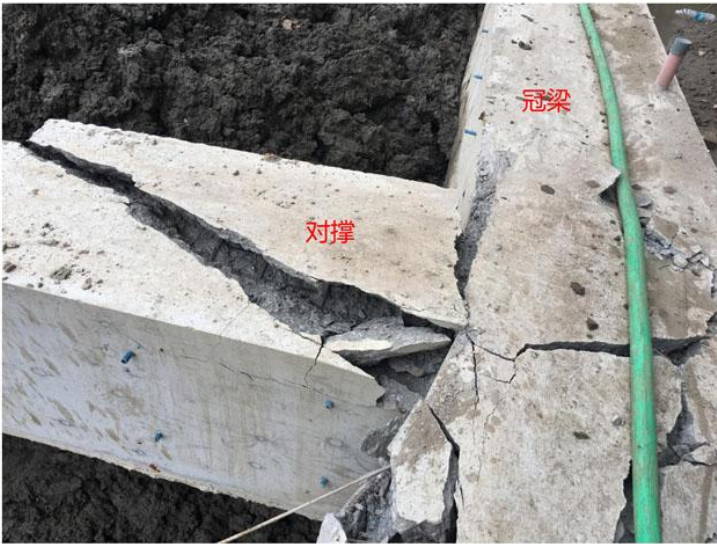
珠海横琴保利项目超载引起的破坏
