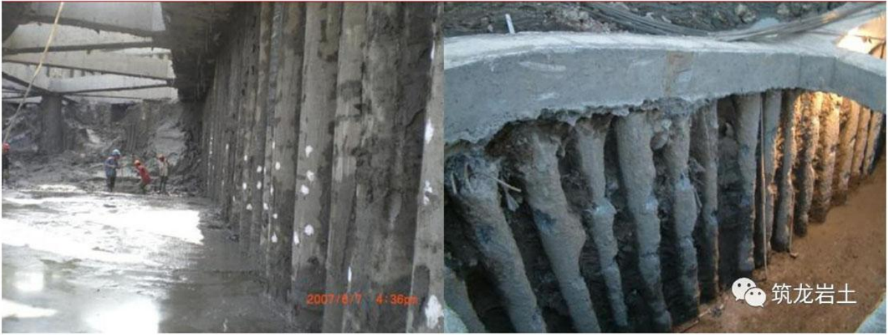
支撑桩抗力不足
