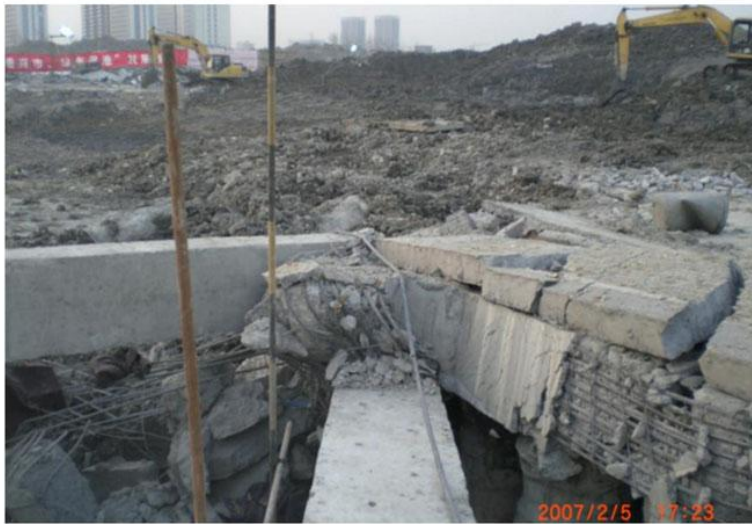
坑外堆土导致支撑体系受力过大
