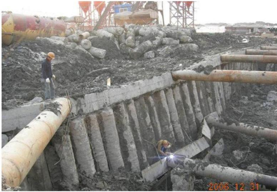
嵌固深度不足，围护桩踢脚，
