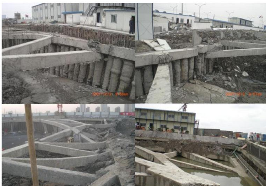
圈梁、钢筋混凝土支撑和系杆的中心线不在同一平面内，圈梁产生局部扭转效应，从而产生混凝土开裂导致锁口刚度严重下降。
